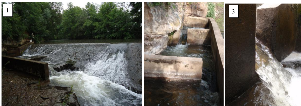
Figure 24 : A Milhars - Courants perturbateurs au niveau de l'entrée et des premiers bassins(1) - Rocher le long de la passe (2), Hauteur de chute au niveau de la deuxième échancrure (3)
