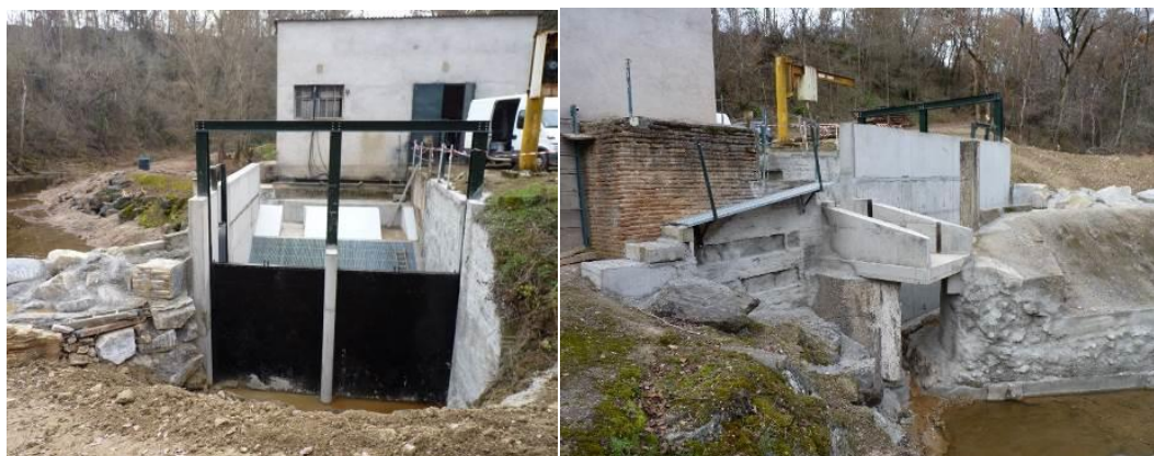
Construction de l'ouvrage de dévalaison au Moulin du Carla sur le Dadou en décembre 2017
